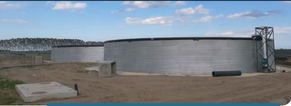
(Lagosanto, provincia di Ferrara, 2021) Due vasche irrigue di accumulo per un'azienda agricola vivaistica, per l'irrigazione delle serre e la rimoltiplicazione delle piante di kiwi. Entrambe hanno un'altezza di 3,12 metri e diametro 20,03 metri e un volume di quasi un milione di litri cadauna.
