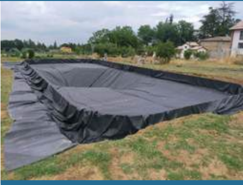
(Parma, 2022) Impermeabilizzazione realizzata impiegando un rotolo intero di Firestone EPDM di spessore 1 mm. misura metri 15,25 x 30,5 per circa 600 Kg. di peso. Due persone in mezza giornata lo hanno steso e fatto sbordare oltre le pareti in acciaio cortén.
