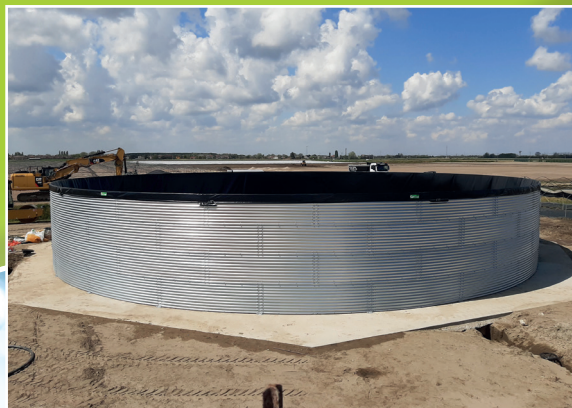
Serbatoi di acciaio per irrigazione e antincendio
